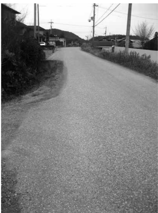
下水道未整備の祇園地先
