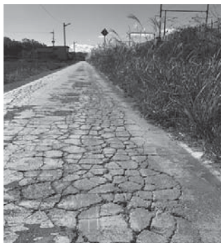
傷みがひどい遊歩道
