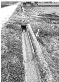
老朽化が進む農業用水路
