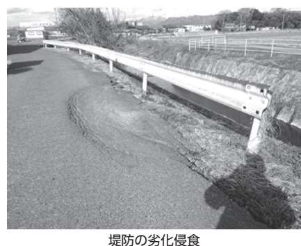
堤防の劣化侵食
