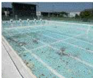
BEFORE (汚れた大プール)
